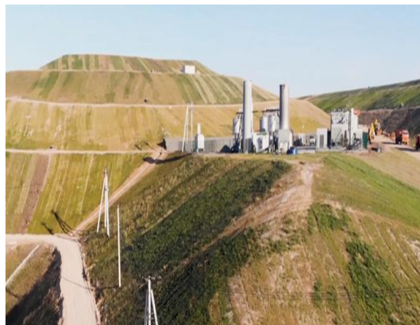
Полигон Кучино, Московская область, установки по генерации энергии из свалочного газа
