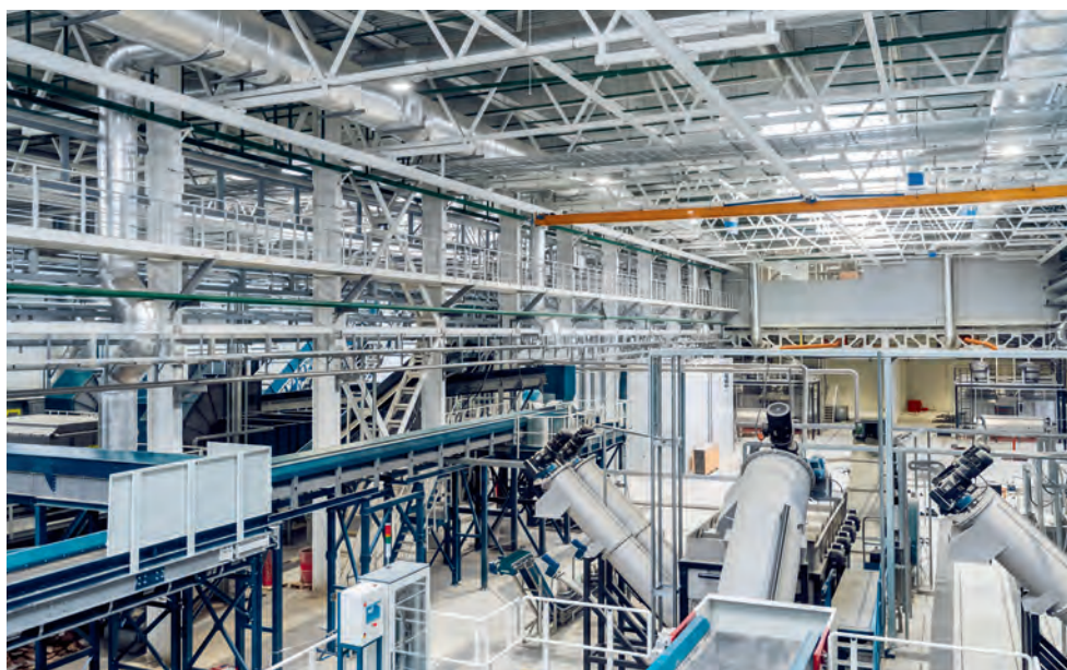
Рис. 3. Внутренний вид линии переработки сырья
